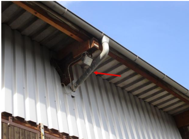
Abb. 15: Vogelkotspuren an Dachrinne (Stand 2021)
